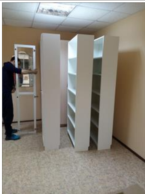
Стеллажи в основном помещении Установка
